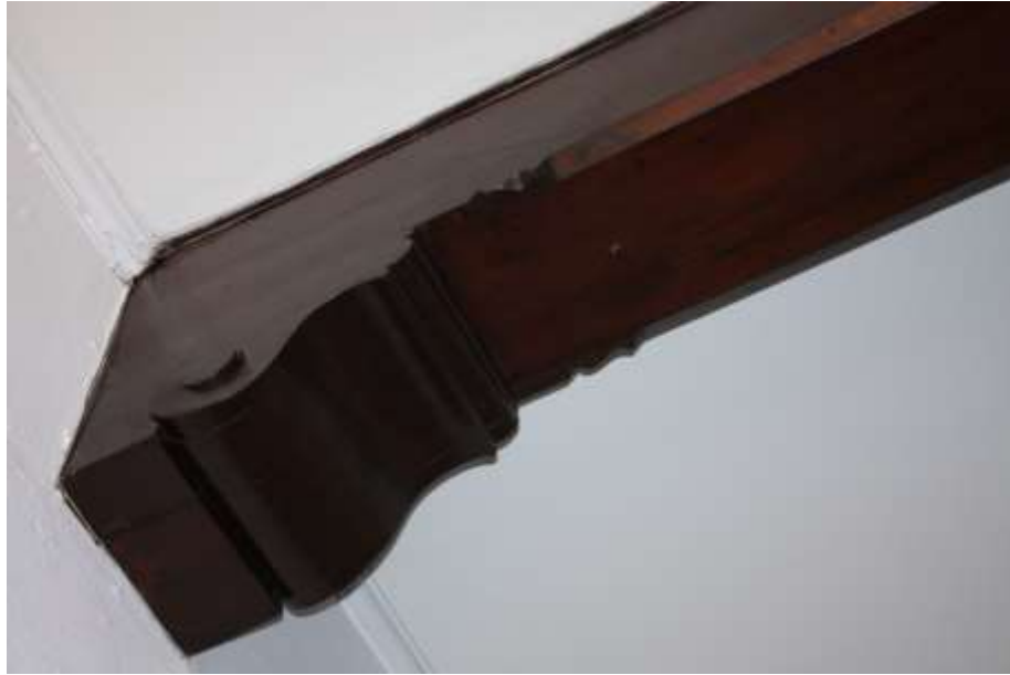
Imagen 45. Ala sur, planta baja. Zaguán lateral poniente. Detalle de la viga. Agosto 2015.
