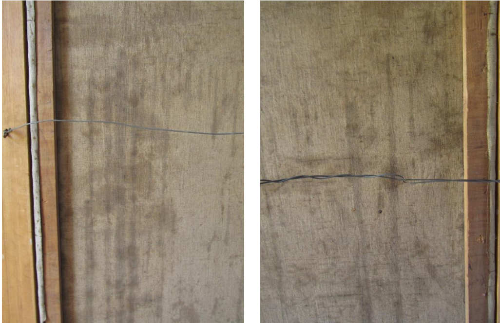
Manchas de escurrimiento en el soporte
