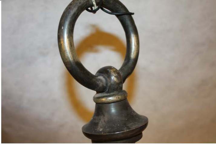
Salpicaduras de pintura, acumulación de polvo y manchas sobre aro de sujeción al cielo.
