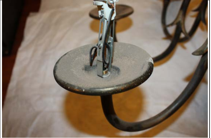
Salpicaduras de pintura y acumulación de polvo sobre plato.
